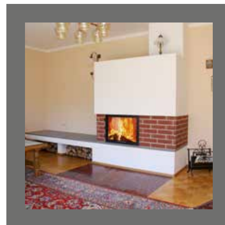
Gotowa instalacja kominkowa w nowoczesnej odstonie.
